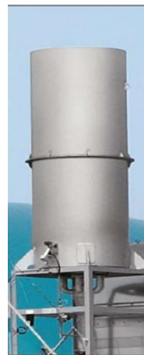
Figure 21 : torchère flamme cachée
