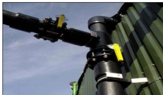
Figure 33 : raccord au niveau des conduites de méthane
