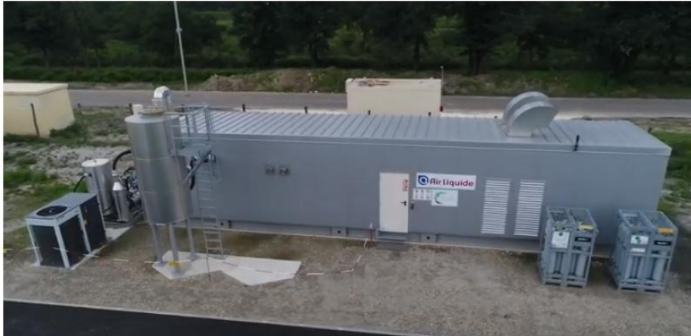
Figure 18 : conteneur épurateur et ses annexes
