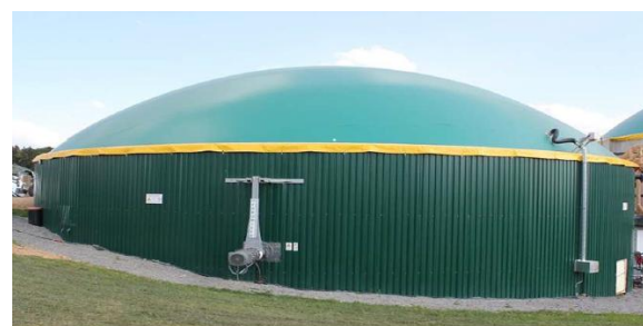
Figure 12 : Digesteur et son gazomètre
