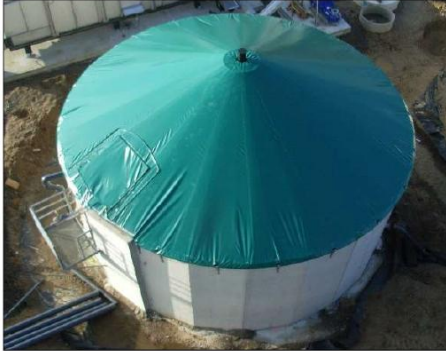
Figure 9 : cuve de 452 m3 pour le stockage des liquides
